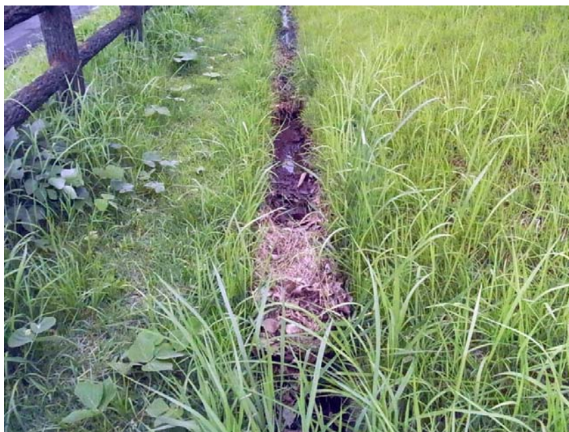
② 小段側溝に発生した 落ち葉による側溝閉 塞
