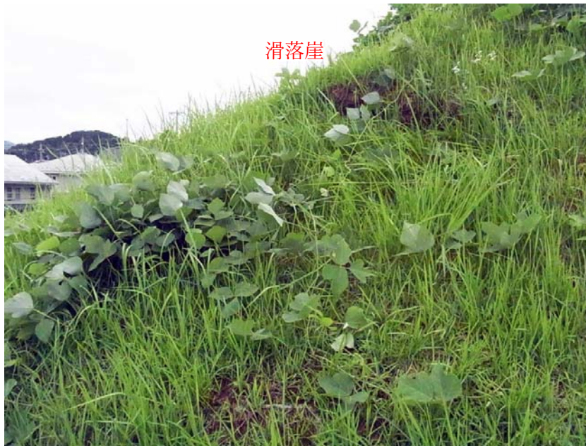
①-2 のり面途中に発生し た滑落崖 (20 c m程 度)。約1m程度長。
