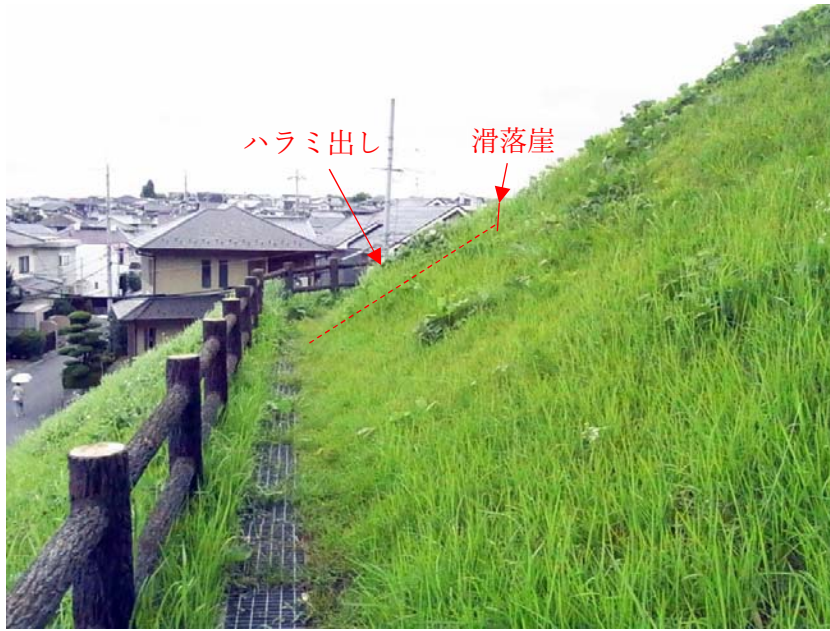
①-1 のり面途中に滑落崖 (20 c m程度)が発生 し、土塊が下位方向に 移動している
