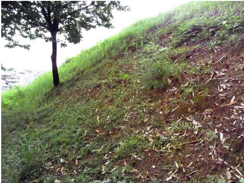
④-1 雨水による表層侵食 と植生流失。流失した 土砂が下位の小段を 閉塞している。
